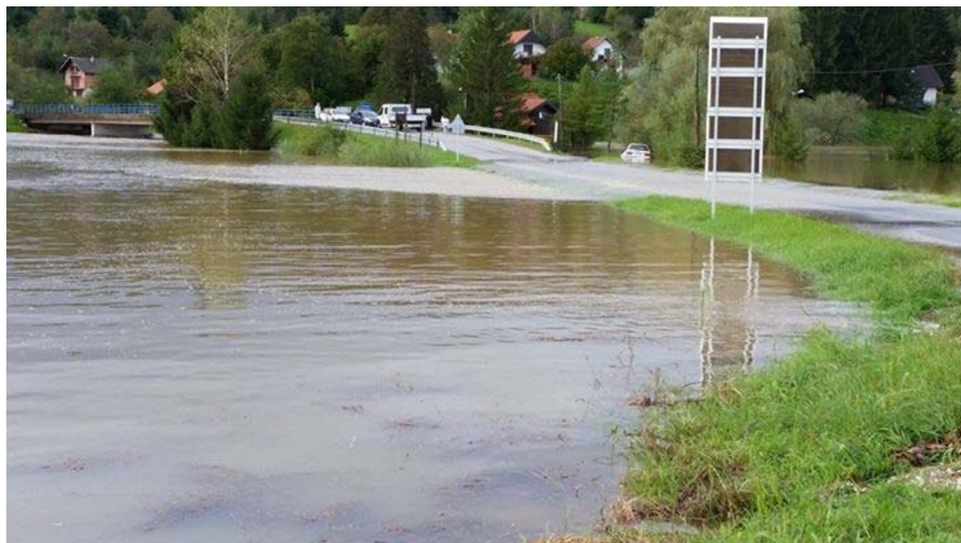
Slika 4. Lokalna cesta LC34082, pogled iz smjera sjevera prema mostu - poplava u rujnu 2014. g.
